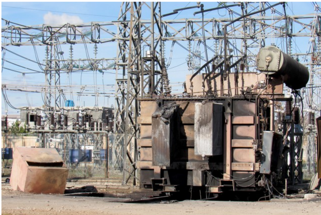
Estació elèctrica d'alta tensió a Tirbespiye després dels atacs al Cantó de Cezire Foto: Joan Vives Cànaves
